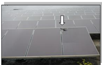
รูปที่ 3 ความเสียหายจากอุบัติเหตุต่อแผงเซลล์แสงอาทิตย์
